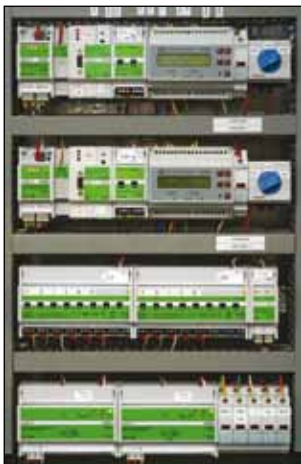
Fig. 3. Componenti KNX nel locale di misura all'ultimo piano.
